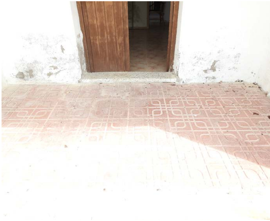
El acceso no cumple con la normativa de accesibilidad y seguridad
