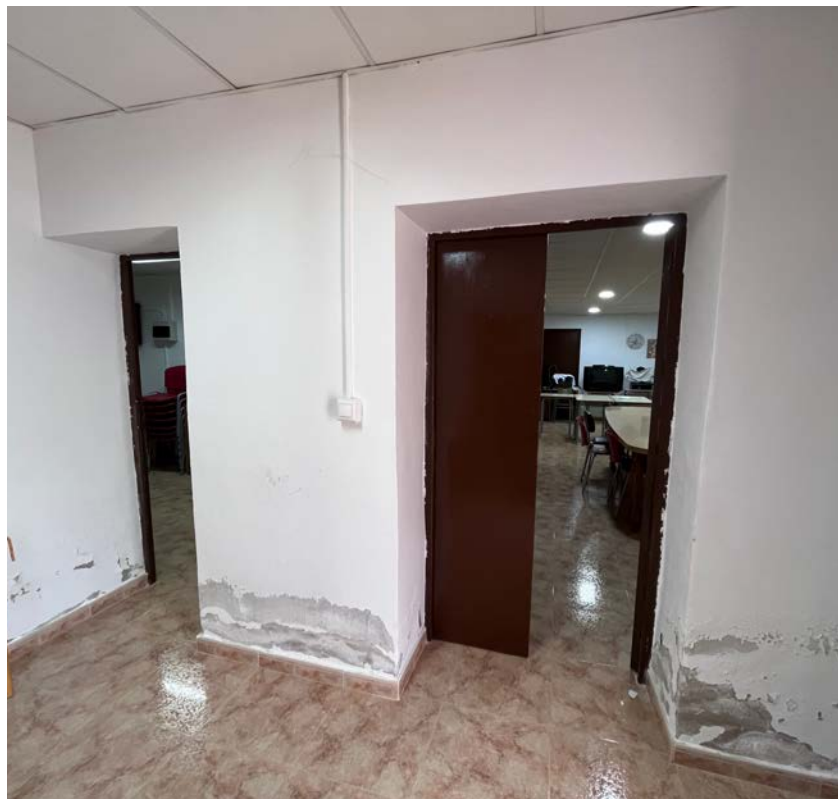
Problemas de humedad en el edificio, desprendimiento de material en paredes
