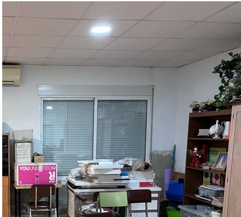
Carpinterías no eficientes en cuanto al aislamiento térmico y acústico del edificio, ya que se trata de carpinterías de aluminio con vidrio simple y sin rotura de puente térmico
