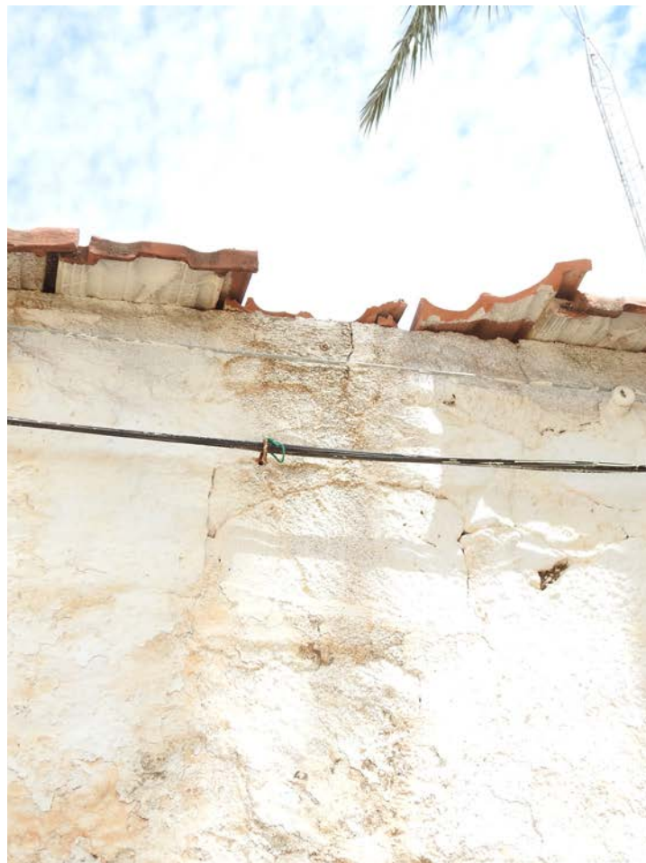
Deficiencias en la impermeabilización de la cubierta debido a la rotura y desprendimiento de tejas cerámicas de la cubierta
