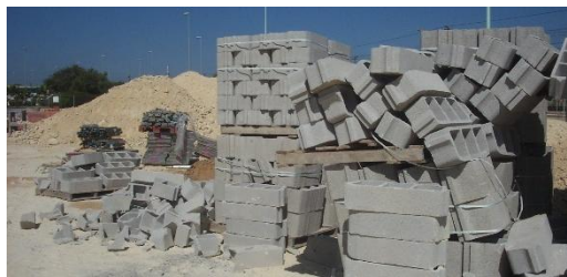
Rotura de material por acopio indebido
